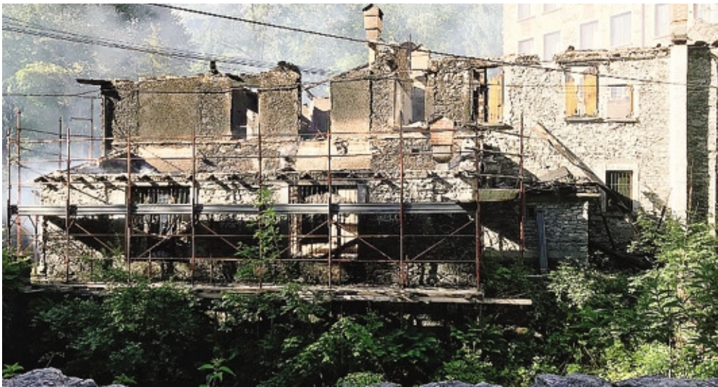
Lo stabile della Taverna del Gigiat andato in fumo nella notte tra lunedì e martedì per un incendio
